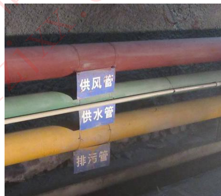
供风、供水实例图
