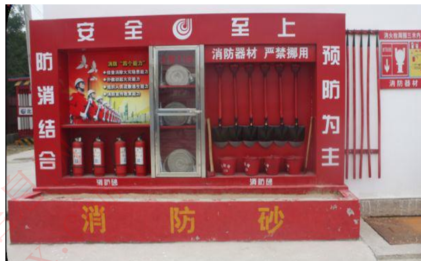
消防设施实例图
